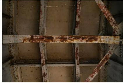
Hình 1.9: Kết cấu bị suy giảm độ cứng do ăn mòn
