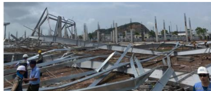
Hình 1.11: Sập nhà xưởng Texhong - Hải Hà (Quảng Ninh)
